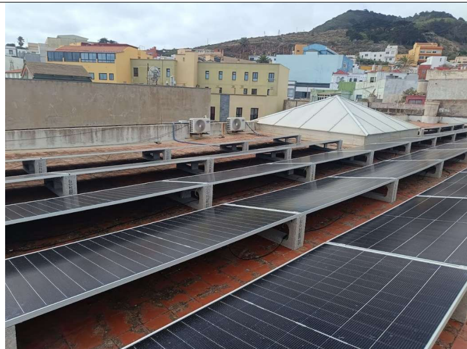
Paneles solares en la casa consistorial
