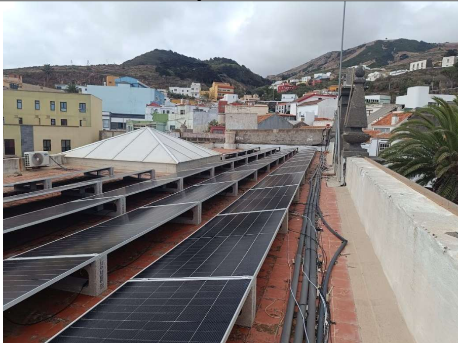
Paneles solares en Casa Consistorial
