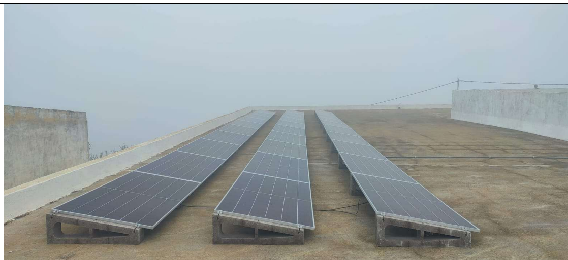
30 Paneles solares fotovoltaicos de 605 W bifaciales sobre solarblocks
