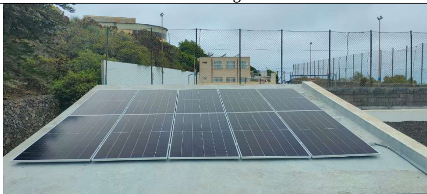
10 paneles fotovoltaicos bifaciales de 605 W
