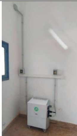
Instalación eléctrica de corriente continua, inversor híbrido con batería y cuadro de corriente alterna
