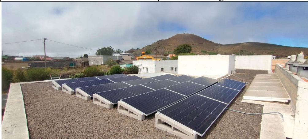
16 paneles fotovoltaicos de 605 W sobre soportes de hormigón
