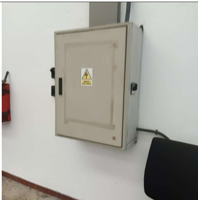
Cuadro almacén principal
