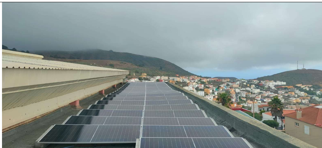
Paneles solares por lateral derecho
