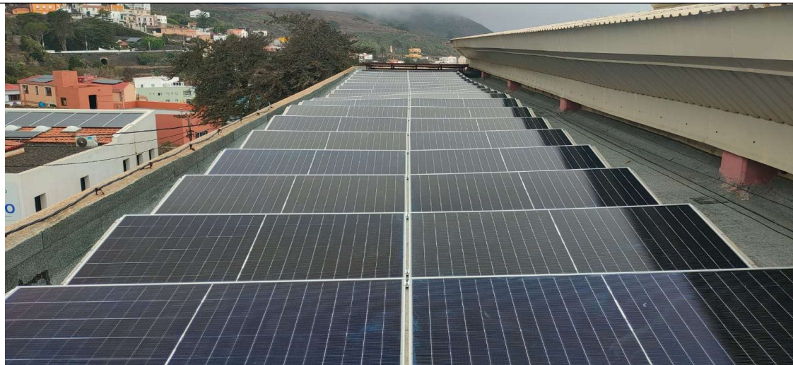
Paneles solares por lateral izquierdo
